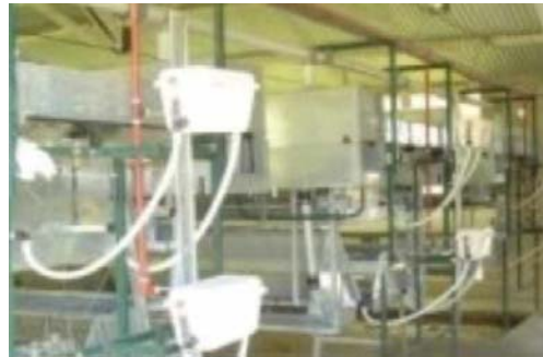
Foto 3.- Depósitos reguladores de agua sistema By-Pass con accesorios.
